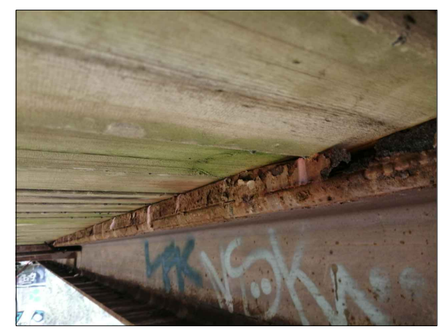
PERFELS #35x35 AVANÇAT ESTAT DE CORROSIÓ
