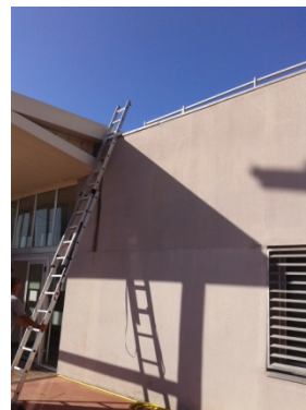
Foto 2. Detall del Punt d'accés. Des de les instal·lacions interiors de la parcel·la de l'edifici
